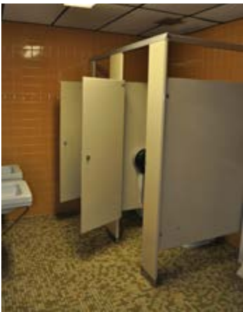
Inaccessible Toilet Stalls
