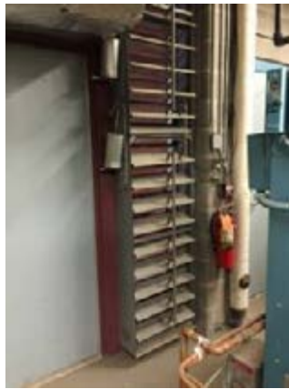
Combustion Air Louver
